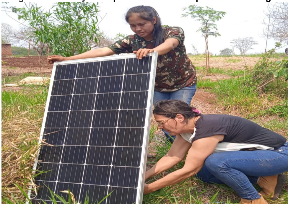
Figura 7. Instalação de placa fotovoltaica para bomba d'água
