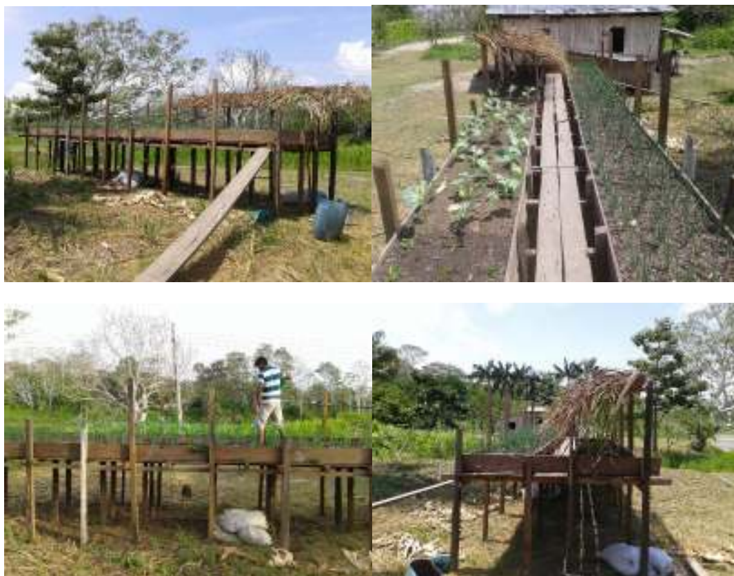
Fotos 1 a 4. Estrutura do Canteiro Suspenso instalada na comunidade Costa da Ilha II
