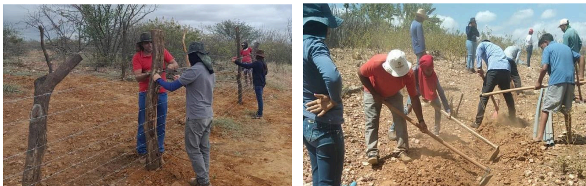
Figura 4 e 5 – (a) construção da cerca e (b) abertura da vala para instalação da adutora
